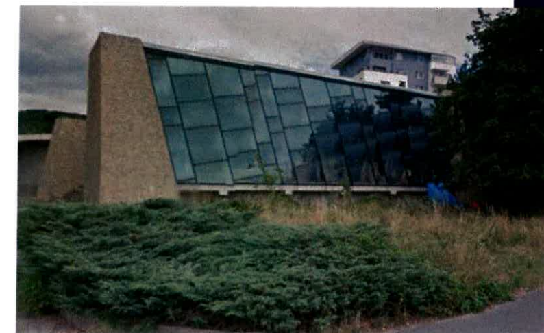
jediná časť presklenia fasády PO s nevyhovujúcou sklenou výplňou
